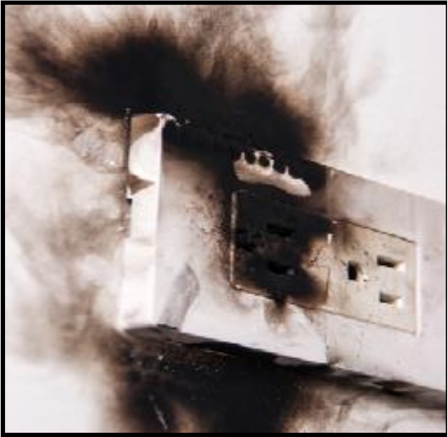
Ổ cắm điện bị chập cháy
