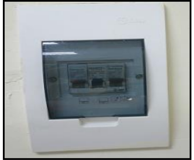
Chọn thiết bị bảo vệ đóng cắt phù hợp và phải có nắp che kín
