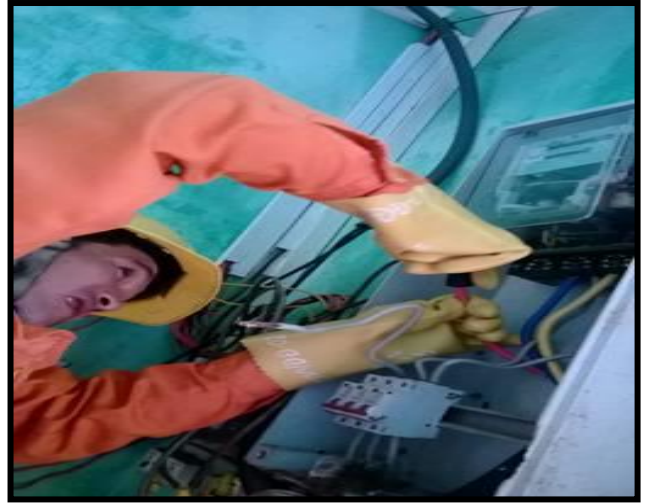
Sửa chữa điện phải đeo găng tay bảo hộ
