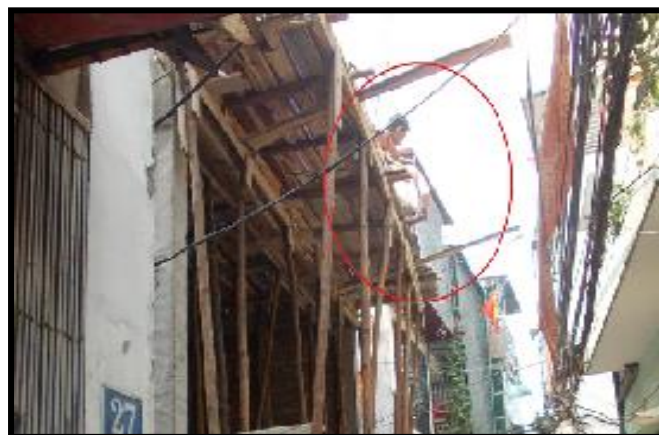
KHÔNG: Xây dựng công trình nhà ở gần đường dây điện
