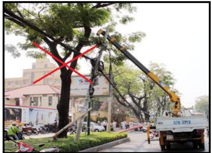
Cây trồng làm ảnh hưởng đến vận hành an toàn đường dây phải tháo dỡ, sửa chữa.
